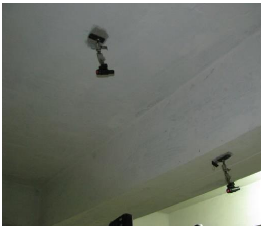
Рис. 11. Лазерні модулі закріплені на плиті перекриття
