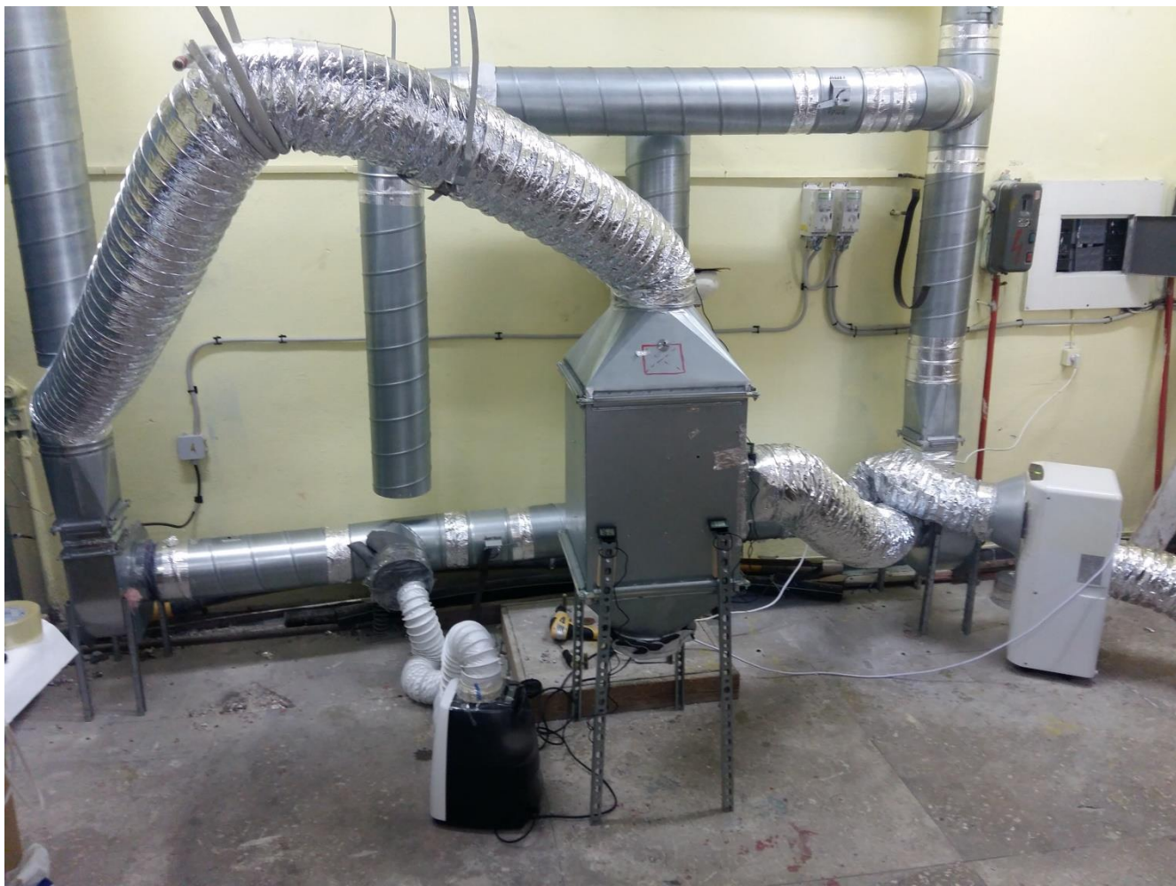
Рис. 3.6 Загальний вигляд блоку зволоження повітря.
