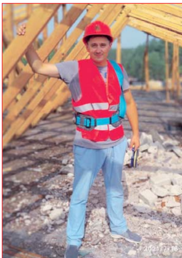
Богдан Герасько проводить в с. Жеревці заміри покрівлі та фасадів під оздоблення металом.
